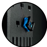
Sujetador de cables instalado
