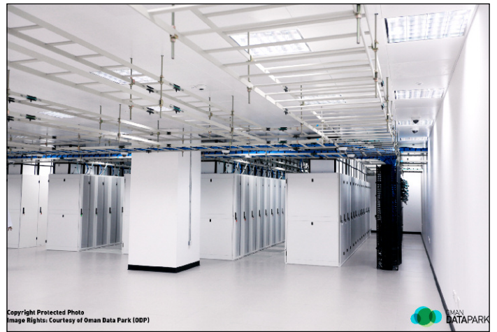
CPI的缆线管理配件把Oman Data Park的数据中心组织起来，使其看上去更干净更整洁。
