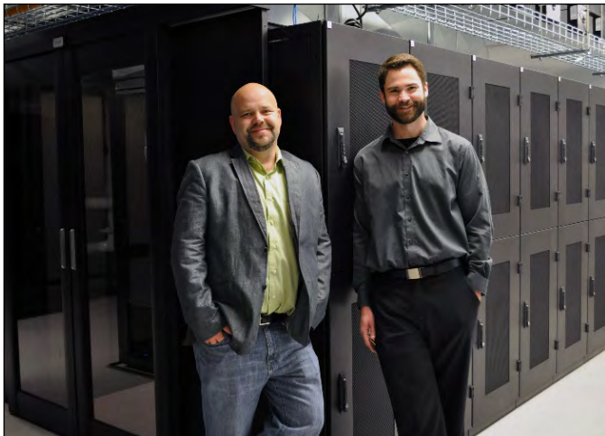
Ken Cox 与 WG Technologies 的 Chris Holt 合作，构建冷通道封闭冷通道封闭。
