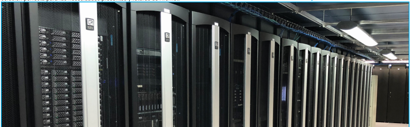
Los gabinetes TeraFrame de la serie F con Ductos de Escape Vertical son la solución estandarizada en el centro de datos de Los Ángeles de Xfernet.
